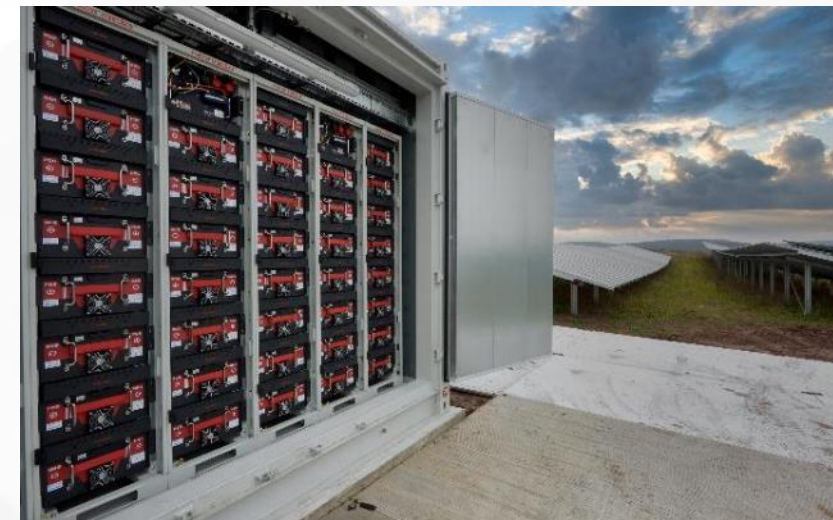
10,2 MWp Bürgersolaranlage zzgl. 7,2 MWh Speicheranlage Reckertshausen
